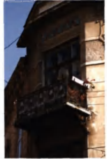
Наріжник будинку № 1. Ковані ґрати та кранштейни балкону. Керамічні полив'яні плитки під карнизом. Збережена автентична рама вікна.
