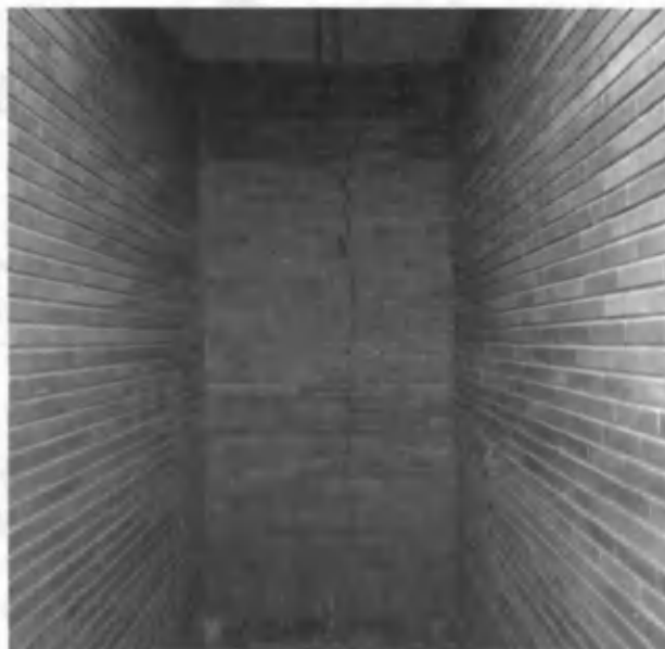
1.22-rasm. Deformatsiya chokini qo‘ymaslik oqibatida devorning yorilishiga misol.
