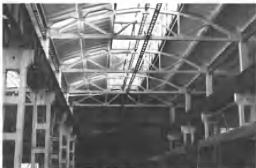
3.4-rasm. Sanoat binosi temir-beton sinchining (ikki shoxli ustun, ferma, qovurg'ali plita, metall bog'lamaning biriktirilishidan tashkil topgan) umumiy ko'rinishi.
