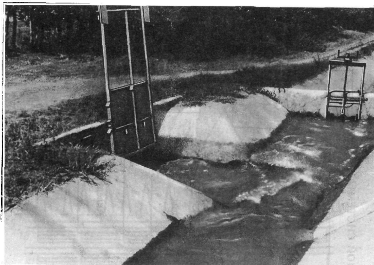
Рис. 32. Вододелитель с регулятором и подпорным сооружением на Правогорлыкской оросительной системе (Ставропольский край)
