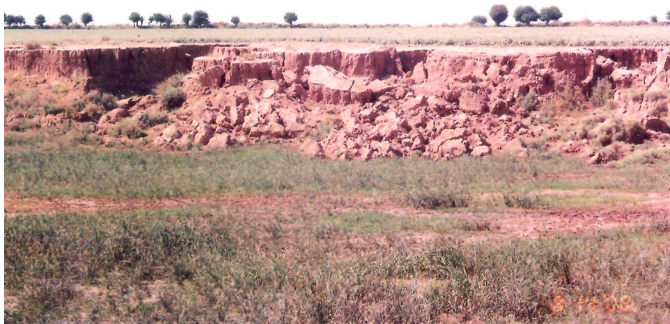
38-расм. Сурхондарё вилояти Шеробод тумани “Чуқуркўл” қишлоғи яқинидаги ногўғри коллектор ўтказилиши натижасида пайдо бўлган жарлик. (2007 йил май).
