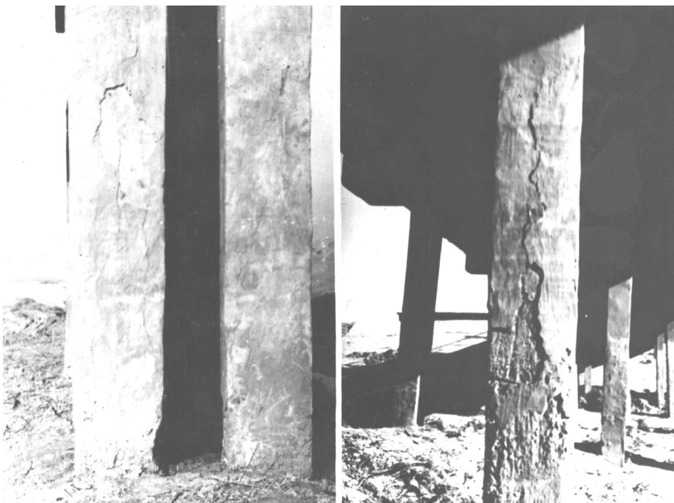
8-rasm . Qoziq-estakadali ko'priklardagi betonning ishqorlanishi va yorilishi
