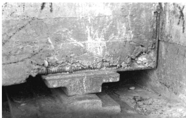
9-rasm . Temirbeton oraliq qurilmasining tangensial tayanch qismi asosi ostki va ustki o'qlarining siljishi, to'sin ishchi armaturasining ochilib qolishi
