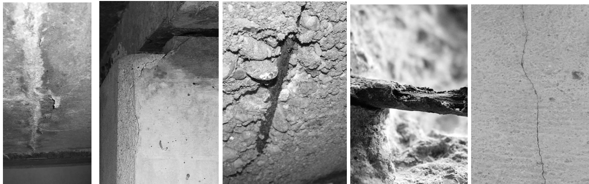
14-rasm. Yuk ko'taruvchi konstruksiyalarda sodir bo'lgan nuqsonlarning turlari
